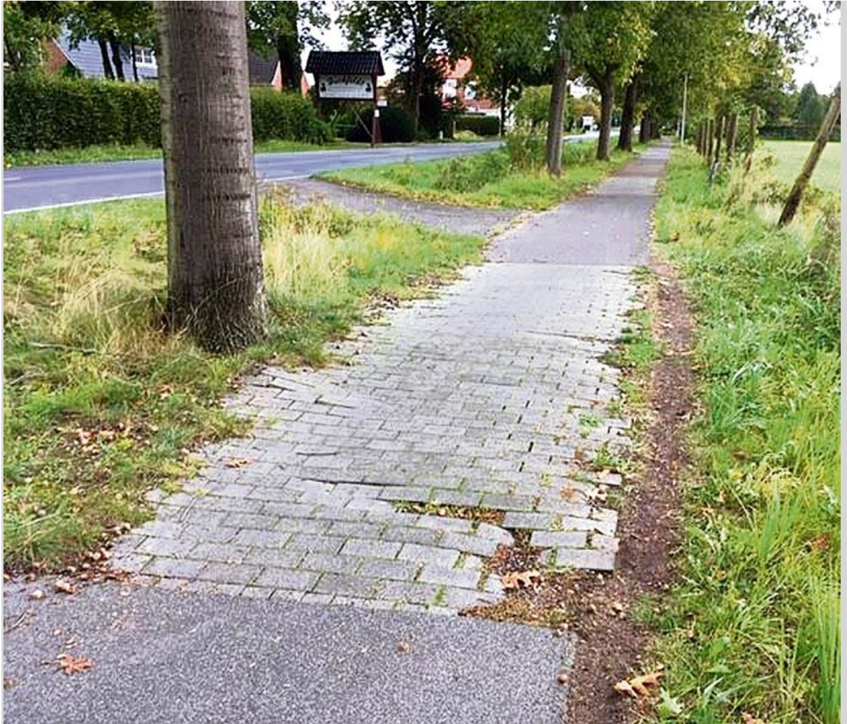
Zahlreiche Schlaglöcher kennzeichnen den Radweg entlang der L 107 zwischen Tornesch und Prisdorf. Johannes Lalla
